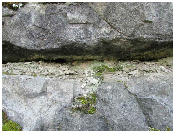
5 STONE LOSS/DELAMINATION SSK-6 SCALE: N.T.S.
