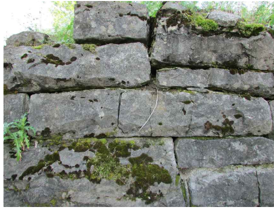
2 VERTICAL CRACK BELOW JOINT SSK-6 SCALE: N.T.S.
